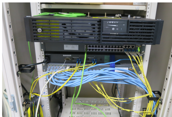
図 1.5: 一次仮復旧の状況
